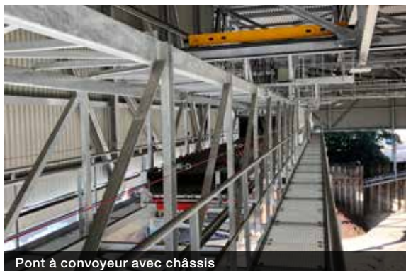
Pont à convoyeur avec châssis
