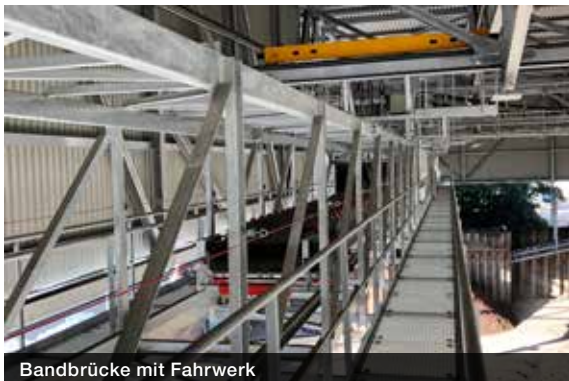
Bandbrücke mit Fahrwerk
