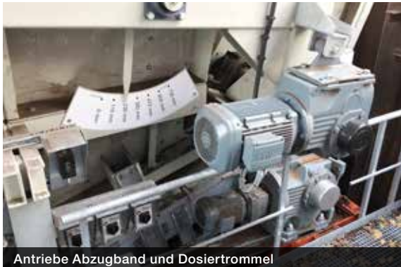
Antriebe Abzugband und Dosiertrommel
