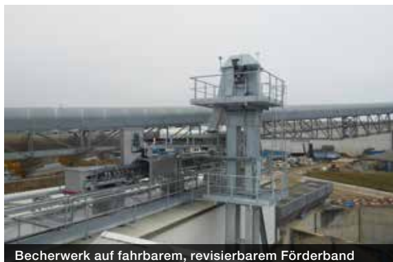
Becherwerk auf fahrbarem, revisierbarem Förderband
