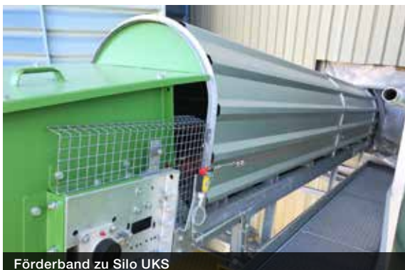
Förderband zu Silo UKS
