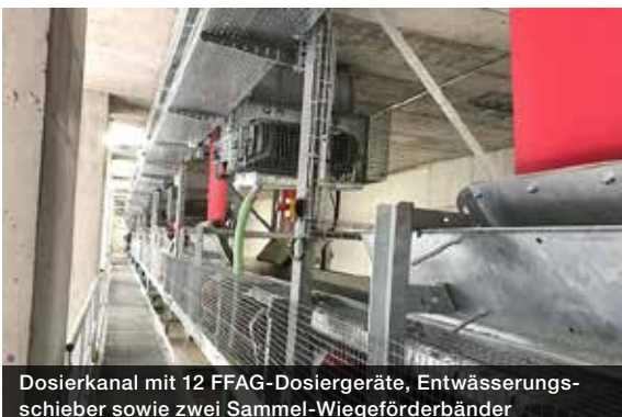
Getrennte Förderanlagen beschicken Vibrationsrinnen mit Schrägboden die auf zwei Setzmaschinen aufgeben
