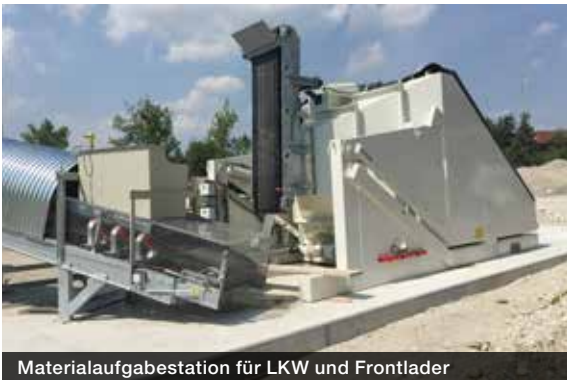
Materialaufgabestation für LKW und Frontlader
