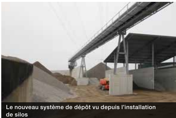
Vue du système de silos à agrégats alimentant le nouveau système de décharge
