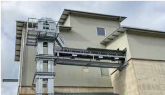
Antriebsstation des Becherwerkes, inkl. Bedienbühne und Querband Bb 500 mm ins Kieswerk und inkl. Begehungen
