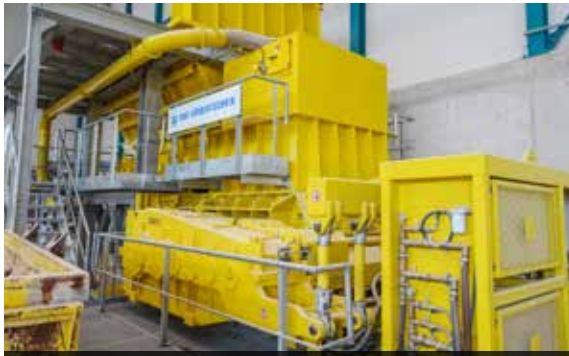
Aufgabebunker mit Vibrationsrinne und Zweiwalzenbrecher
