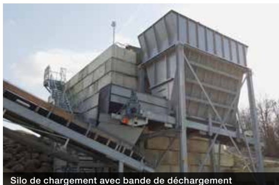
Silo de chargement avec bande de déchargement
