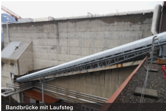
Bandbrücke mit Laufsteg
