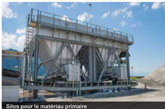
Silos pour le matériau primaire
