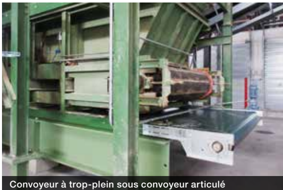
Convoyeur à trop-plein sous convoyeur articulé
