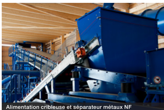
Alimentation cribleuse et séparateur métaux NF
