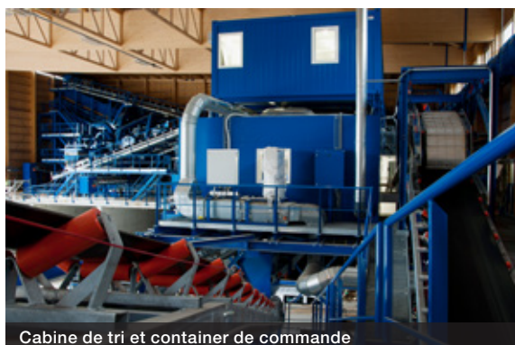
Cabine de tri et container de commande
