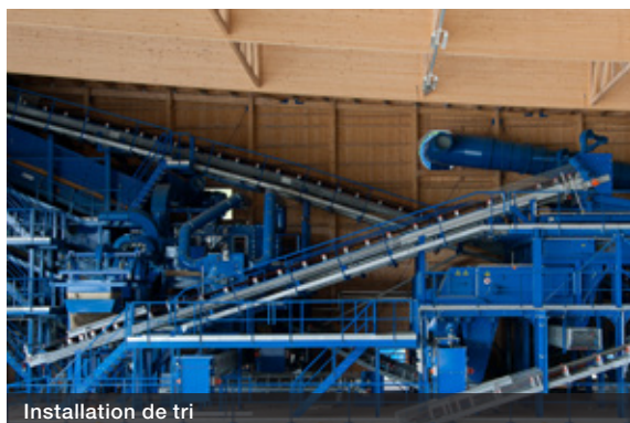
Installation de tri
