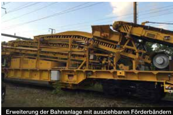
Erweiterung der Bahnanlage mit ausziehbaren Förderbändern
