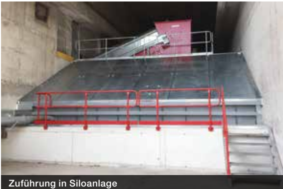
Zuführung in Siloanlage
