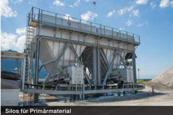
Silos für Primärmaterial
