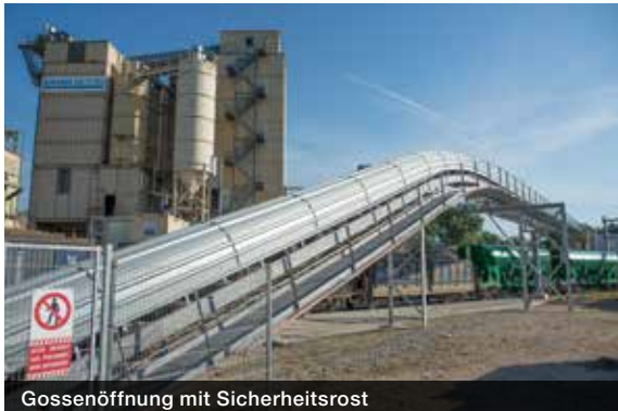
Gossenöffnung mit Sicherheitsrost
