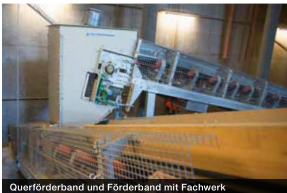
Querförderband und Förderband mit Fachwerk
