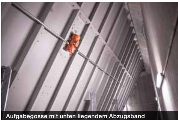
Aufgabegosse mit unten liegendem Abzugsband
