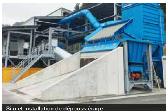
Silo et installation de dépoussiérage
