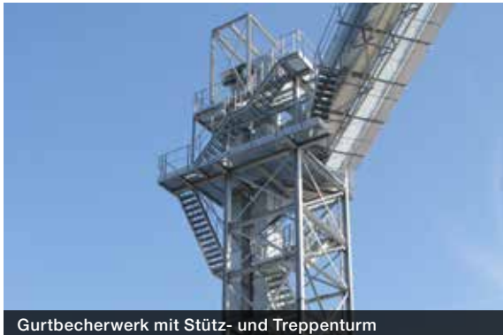
Gurtbecherwerk mit Stütz- und Treppenturm
