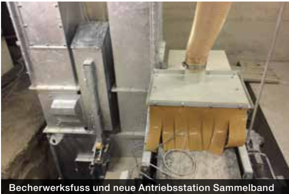
Becherwerksfuss und neue Antriebsstation Sammelband
