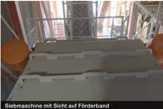
Siebmaschine mit Sicht auf Förderband
