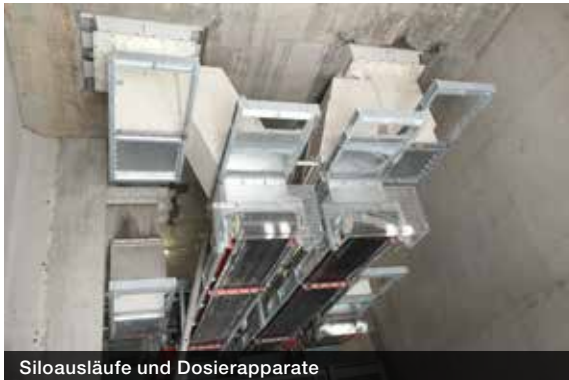
Siloausläufe und Dosierapparate
