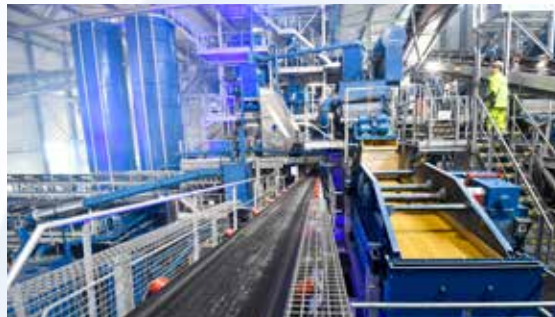
RCO Recycling Center Ostschweiz AG, Niederstetten Construction waste recycling system
