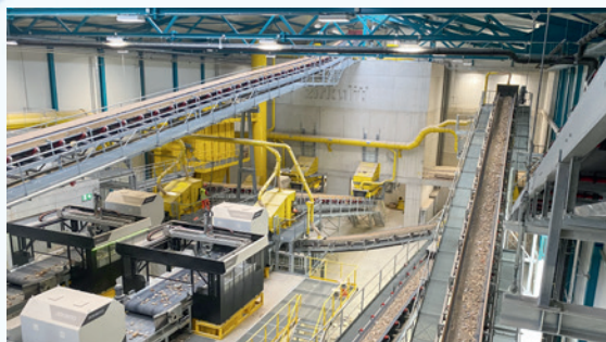
Eberhard Bau AG, Oberglatt Centre de traitement EbiMIK
