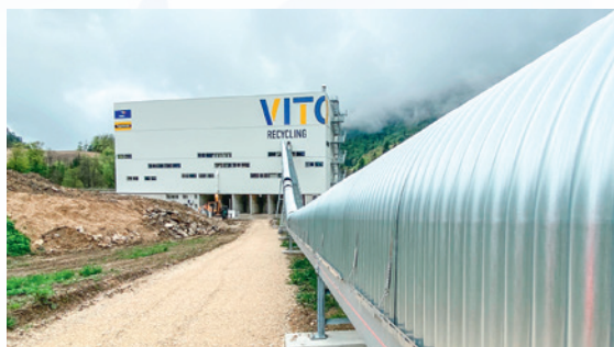
VITO Recycling AG, Péry-La Heutte Installation de lavage des sols
