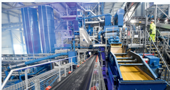
RCO Recycling Center Ostschweiz AG, Niederstetten Installation de recyclage de matériaux de construction
